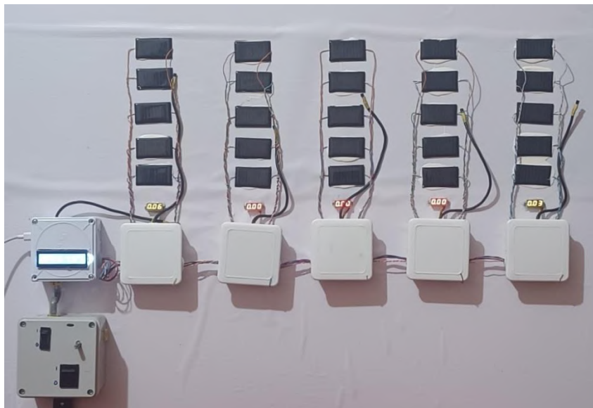
Рис. 2. Внешний вид экспериментального устройства для мониторинга воздействия окружающей среды на фотоэлектрические батареи в реальных условиях
