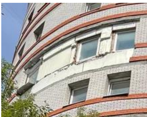
Рис. 1. Фасад 9-этажного жилого дома во время обследования
