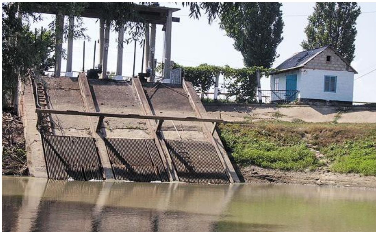
Рис. 1. Головное водозаборное устройство Черноерковской рисовой оросительной системы
